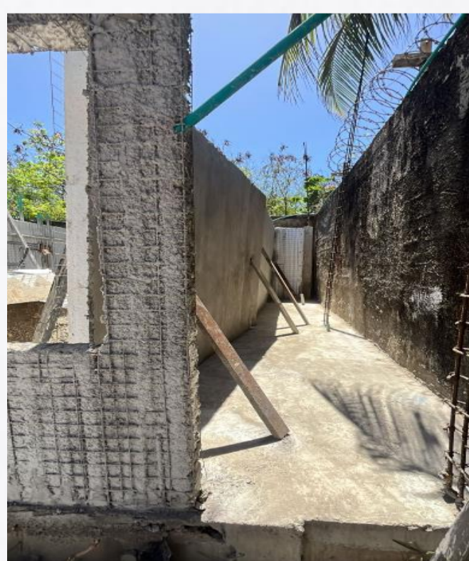
Escarche de muros en Durapanel Fuente: Elaboración propia
