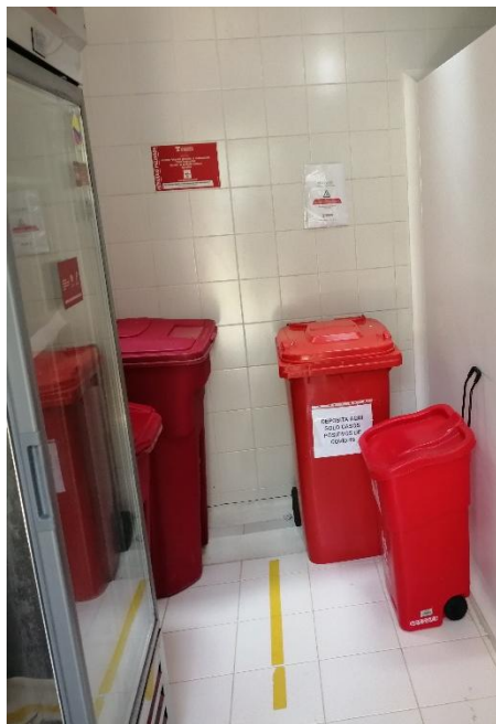
Almacenamiento residuos hospitalarios
