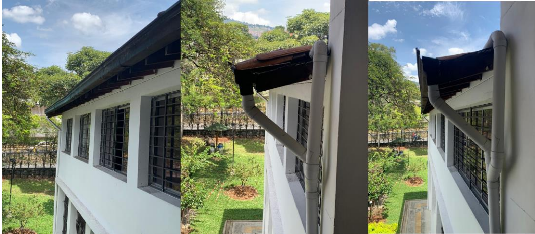
Canaleta - Bloque patrimonial Colmayor
