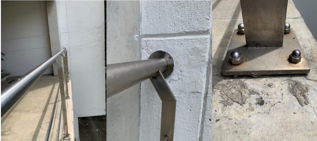
Baranda metálica - Bloque académico Colmayor
