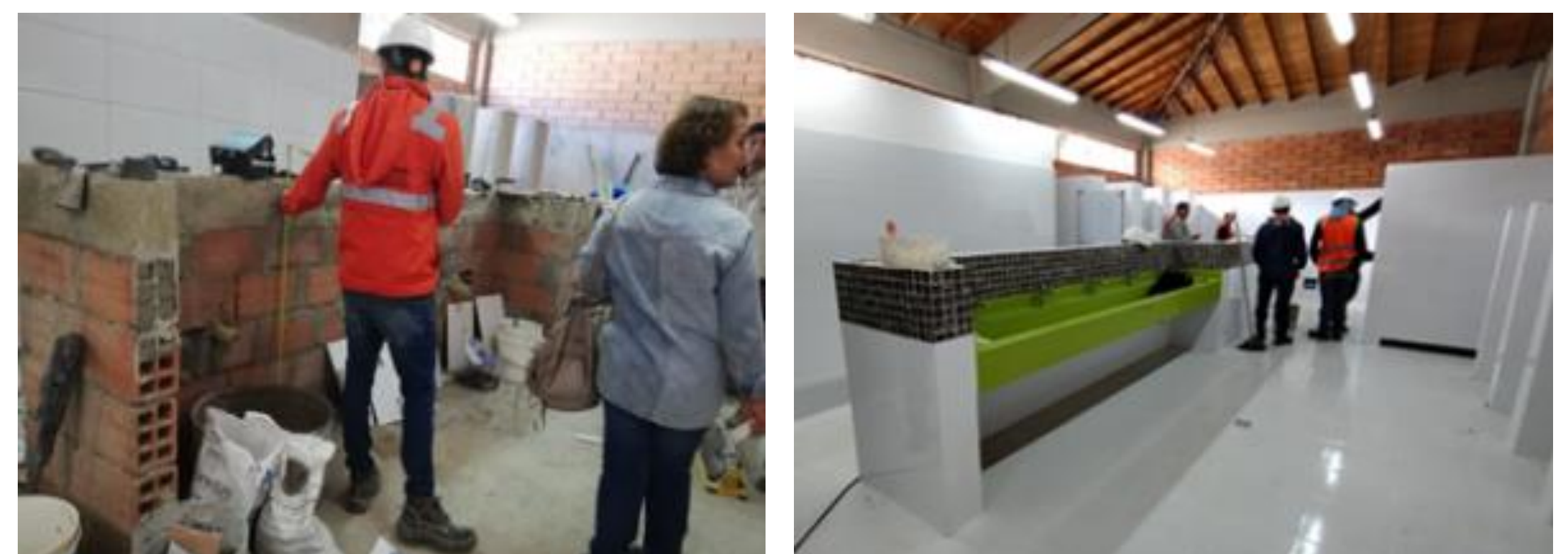
Imagen # 4-5. Adecuación Baño Niños I.E Santa Elena tres meses despues de empezar obra.
