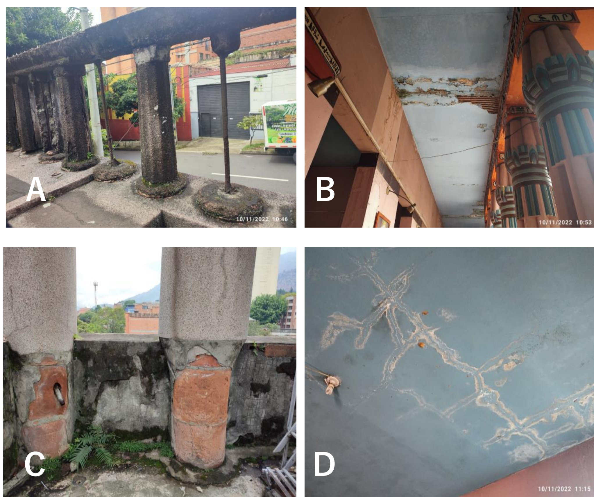
Figura 4. Lesiones patológicas Palacio Egipcio. a) Desprendimiento de material. b) Humedad. c) Crecimiento de material vegetal. d) Eflorescencia.
