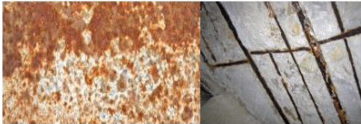
CORROSION Y OXIDACION
