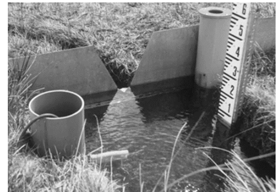
Estructuras hidráulicas (vertederos, canaletas parshall)
