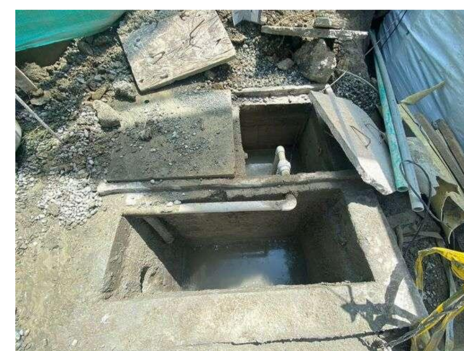
Figura 10: Caja recirculación agua planta concretos. Imagen propia
