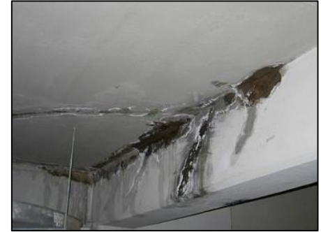
Humedades por filtración
