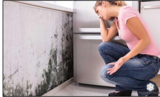
Humedades por capilaridad
