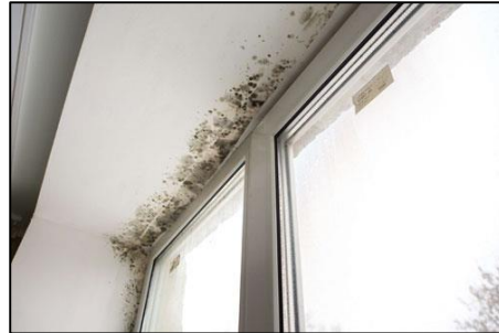
Humedades por condensación
