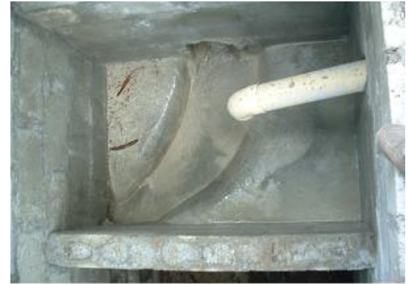
Cajas de inspección
