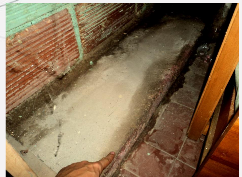
Presencia de humedad capilar en muros de cerramiento
