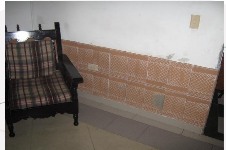
Soluciones inadecuadas para problemas de humedad capilar
