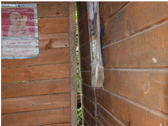
Fotografía: Santiago Rodríguez Restrepo Grieta de pared-1. 29/10/2012 – 11:29 a.m.
