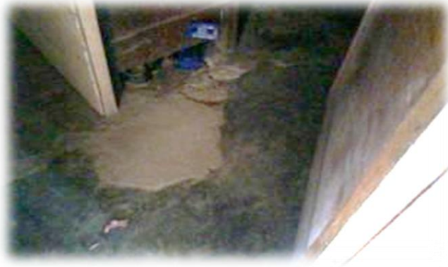
Fotografía 5. Hundimiento del suelo en el corredor de la casa Natalia Díaz, y, Alejandro García. Fecha: 29-10-2012
