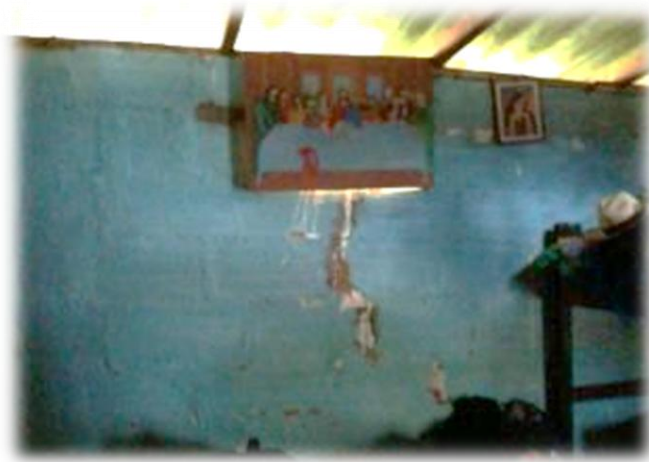
Fotografía 3. Grietas de las paredes Natalia Díaz, y, Alejandro García. Fecha: 29-10-2012
