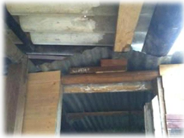
Fotografía 7. Condiciones del Techo Natalia Díaz, y, Alejandro García. Fecha: 29-10-2012
