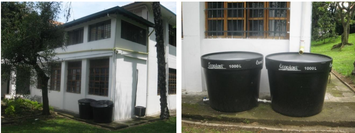
Ilustración 5 Sistema piloto de captación y almacenamiento de agua lluvia en la Institución Universitaria Colegio Mayor de Antioquia.
