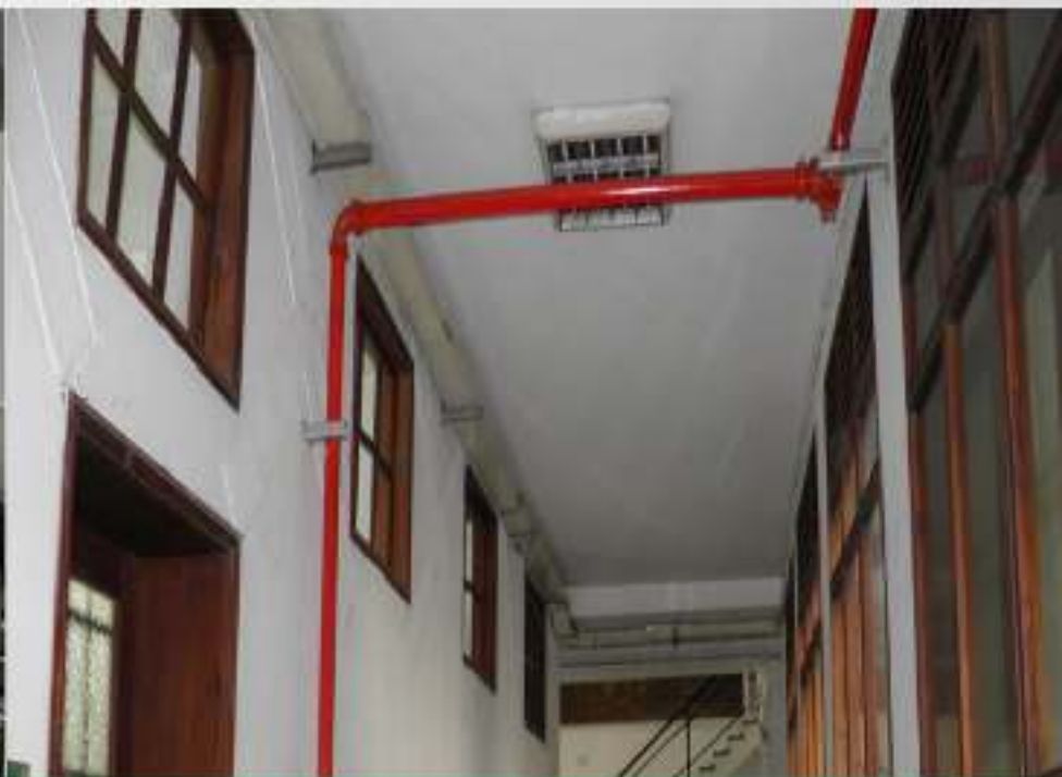
RED CONTRA INCENDIOS
